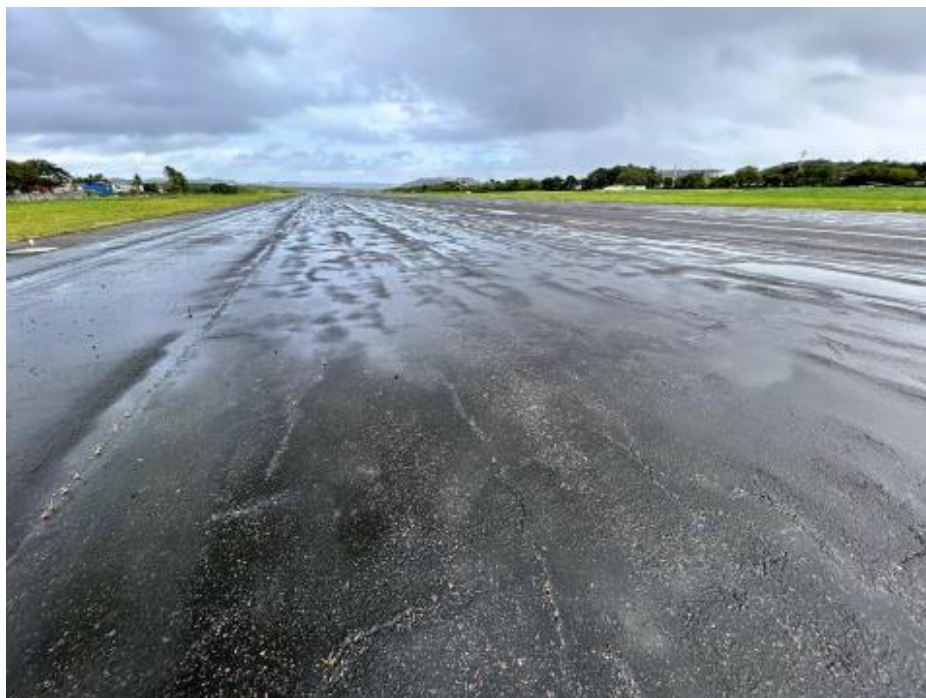
Figura 10 – Pista de Pouso e Decolagem
