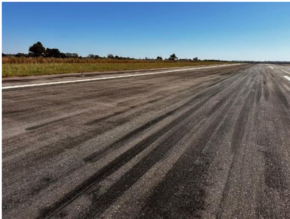
Figura 10 – Pista de pouso e decolagem
