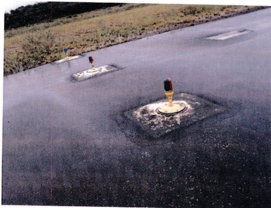
Figura 55 - Balizamento Noturno Cabeceira 03
