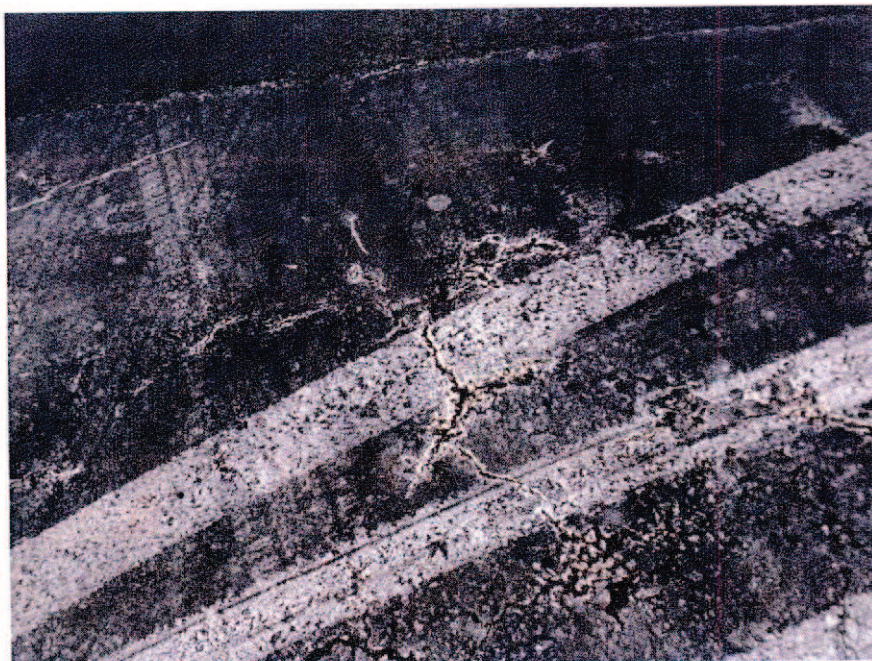
Figura 44 - Fissuras Longitudinais (próximas a cabeceira 03)
