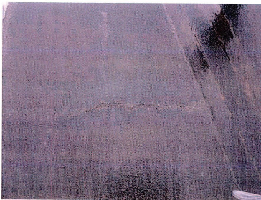
Figura 47 – PPD - Superfície lodosa no pavimento
