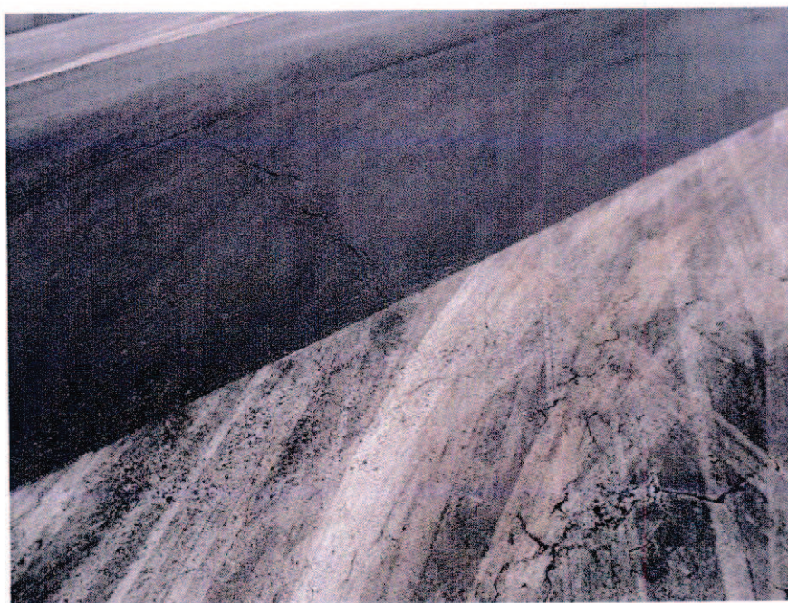
Figura 45 - Fissuras Longitudinais (próximas a cabeceira 21)
